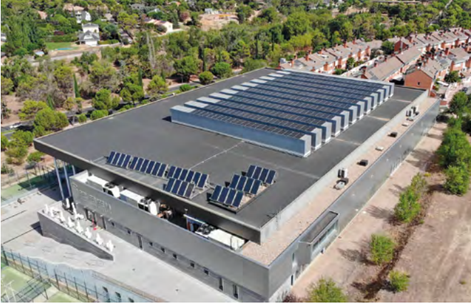
Placas solares instaladas en la cubierta del polideportivo Rey Felipe VI, en Viñas Viejas.
